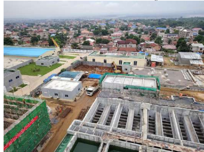
Vue aérienne des filtres du Module 3
