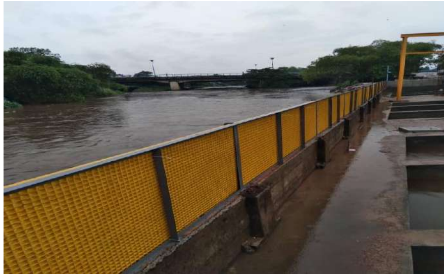
Station de captage N'djili : Grilles de protection au niveau des dessableurs
