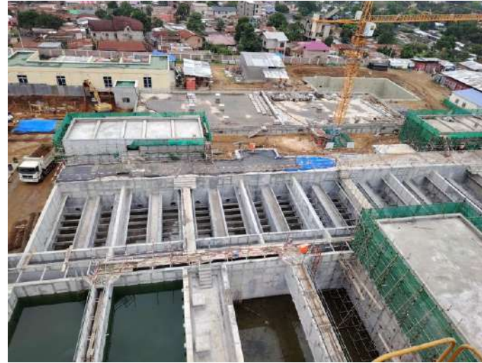
Vue aérienne des filtres, des réservoirs et de la bache d'homogénéisation du Module 3.
