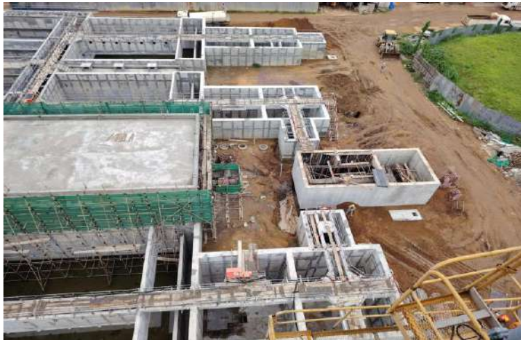
Vue aérienne des coagulateurs et des flocculateurs du Module 3
