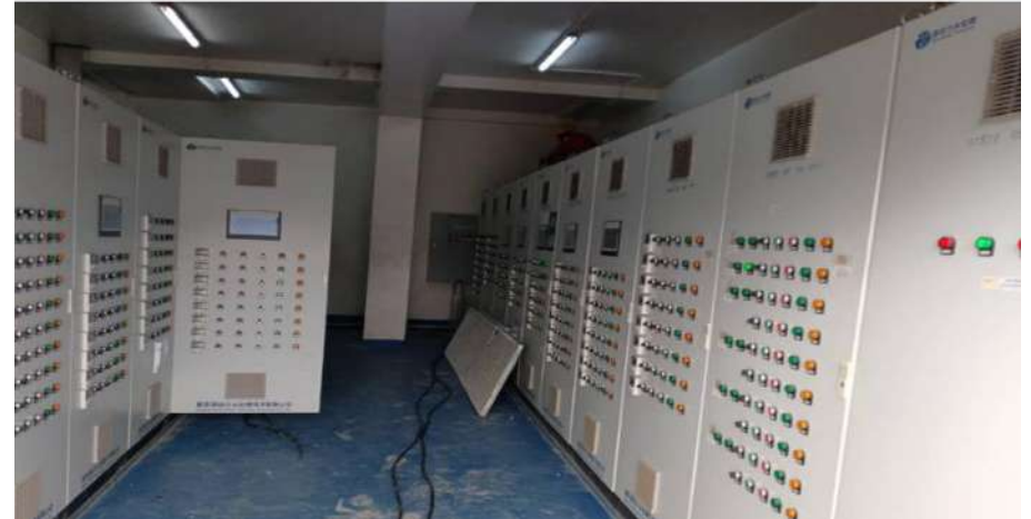
Montages des armoires BT
