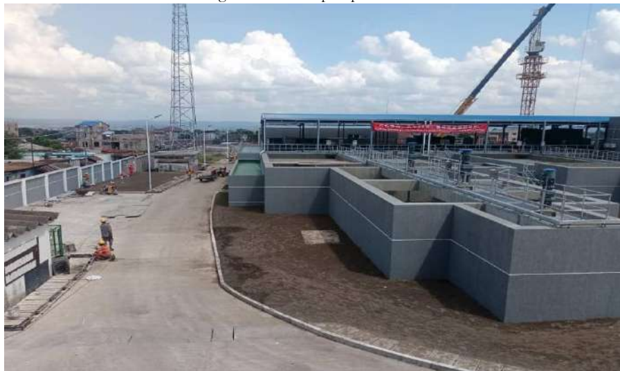
Ouvrage de coagulation
